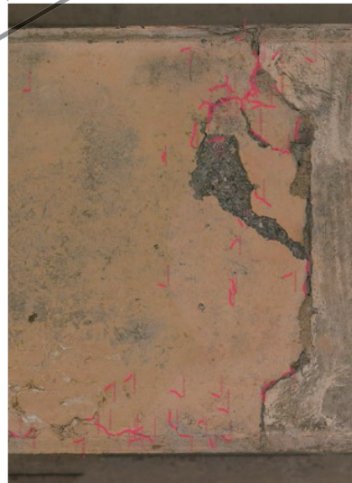
自動検知されたひび割れは色分けされる
